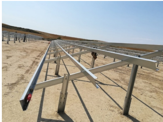
ILUSTRACIÓN 9: Estructura hincada biposte
