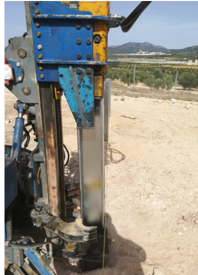
ILUSTRACIÓN 34: Ensayo de tracción
