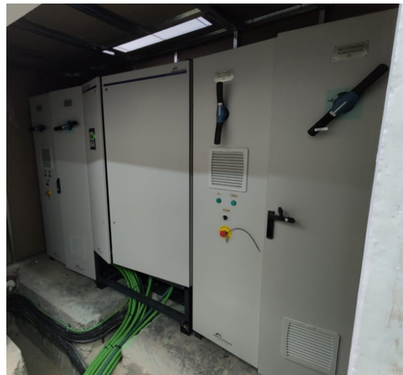
ILUSTRACIÓN 26: Inversores Power Electronics
