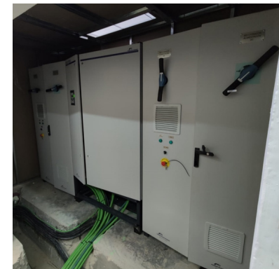
ILUSTRACIÓN 14: Inversores Power Electronics
