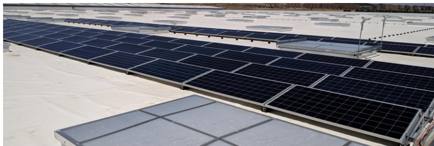
ILUSTRACIÓN 29: Estructura metálica lastrada
