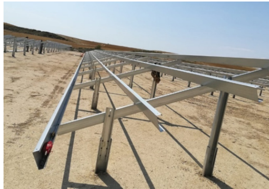
ILUSTRACIÓN 32: Estructura hincada biposte
