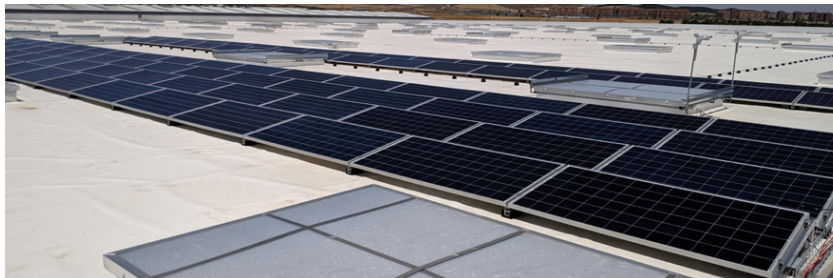
ILUSTRACIÓN 24: Estructura metálica lastrada
