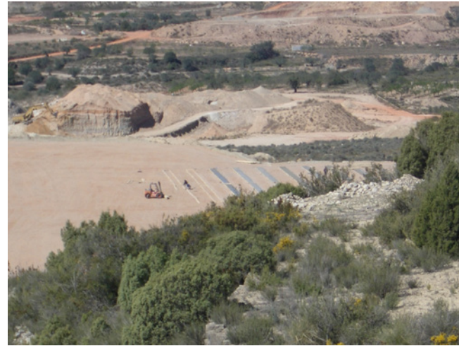
Detalle de los trabajos de instalación de las placas. Al fondo puede verse el desarrollo de las labores de restauración, con el aporte de estériles de la explotación, para relleno de huecos mineros.
