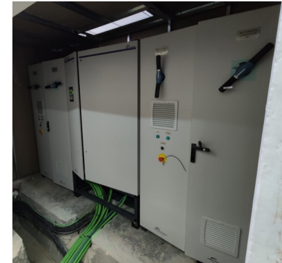
ILUSTRACIÓN 6: Inversores Power Electronics
