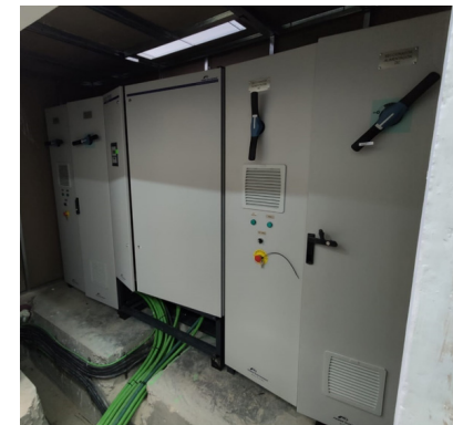
ILUSTRACIÓN 21: Inversores Power Electronics
