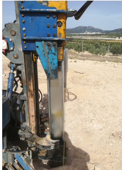
ILUSTRACIÓN 18: Ensayo de tracción
