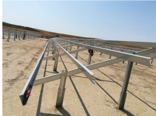
ILUSTRACIÓN 1: Estructura hincada biposte
