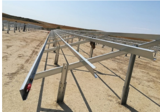
ILUSTRACIÓN 16: Estructura hincada biposte
