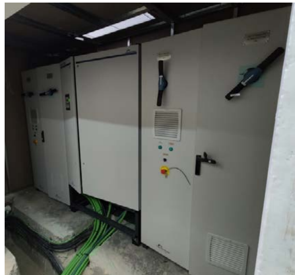
ILUSTRACIÓN 26: Inversores Power Electronics
