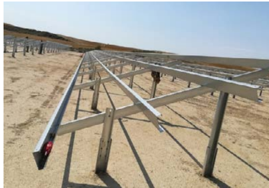
ILUSTRACIÓN 32: Estructura hincada biposte
