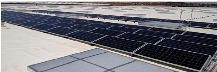
ILUSTRACIÓN 24: Estructura metálica lastrada
