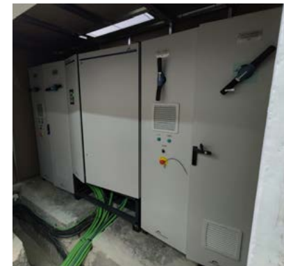
ILUSTRACIÓN 37: Inversores Power Electronics
