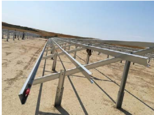
ILUSTRACIÓN 9: Estructura hincada biposte
