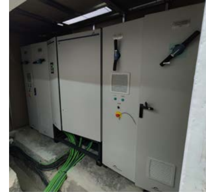
ILUSTRACIÓN 6: Inversores Power Electronics
