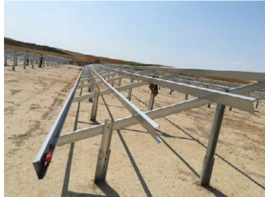
ILUSTRACIÓN 1: Estructura hincada biposte
