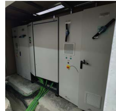
ILUSTRACIÓN 14: Inversores Power Electronics
