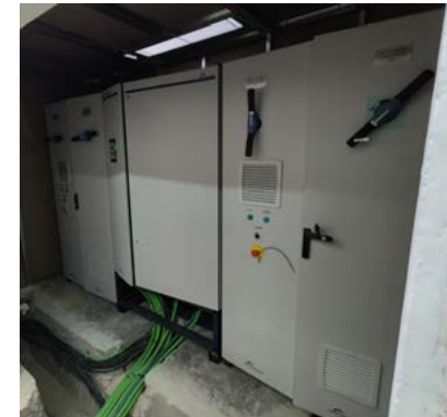
ILUSTRACIÓN 21: Inversores Power Electronics
